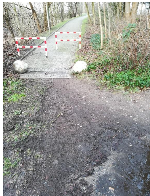
Abbildung 30: Schlechte Streckenbedingungen auf Höhe Rampenbauwerk Nikolaiallee / Lilienthalstraße (eigene Abbildung)
